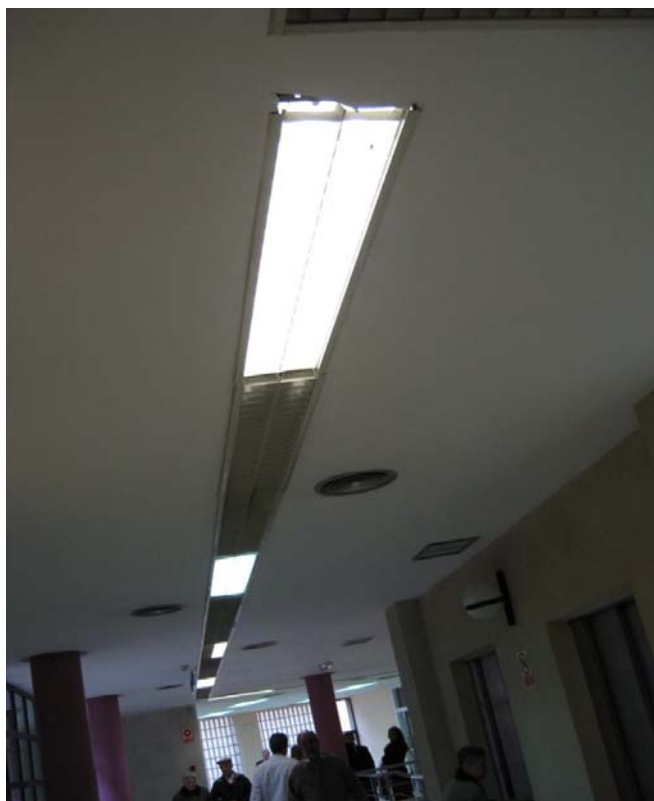
Iluminación en CS Las Fuentes Norte
