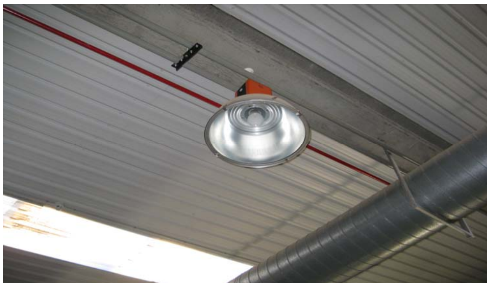
Lámpara en nave de ensayos
