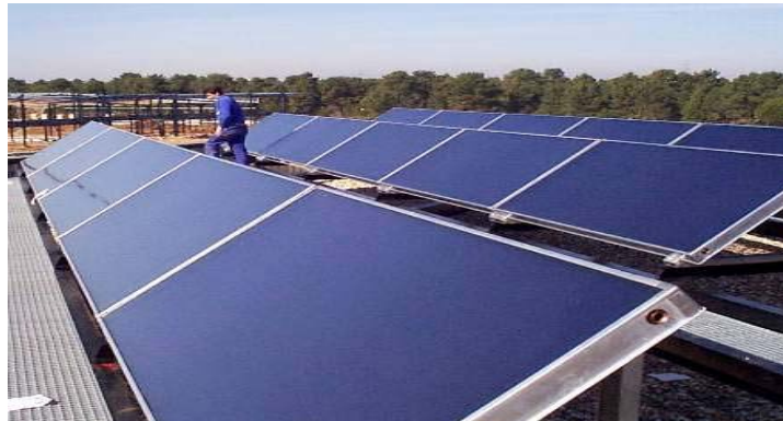
Fotografía A1.1. Conjunto de captadores solares planos
